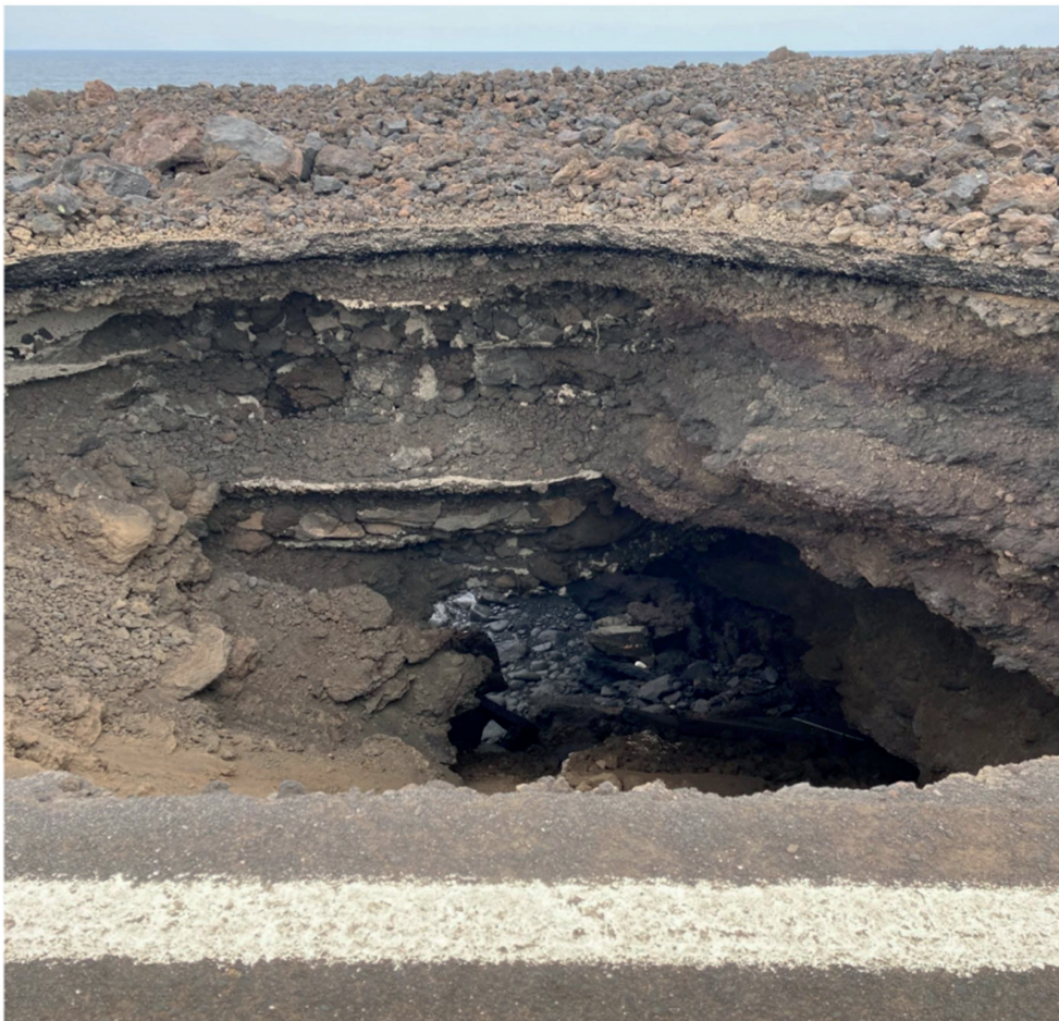
Figura 1. Foto del tramo hundido en la carretera Lz-703 el mes de febrero 2021 Foto: (Wargnier,2021).
