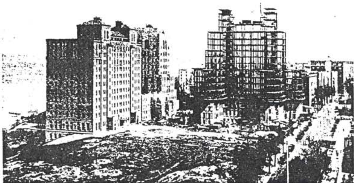
Falta terminar uno de los cuerpos de edificio - el cual, como el otro, tendrá quince plantas, con departamentos para enfermos de todas clases.
