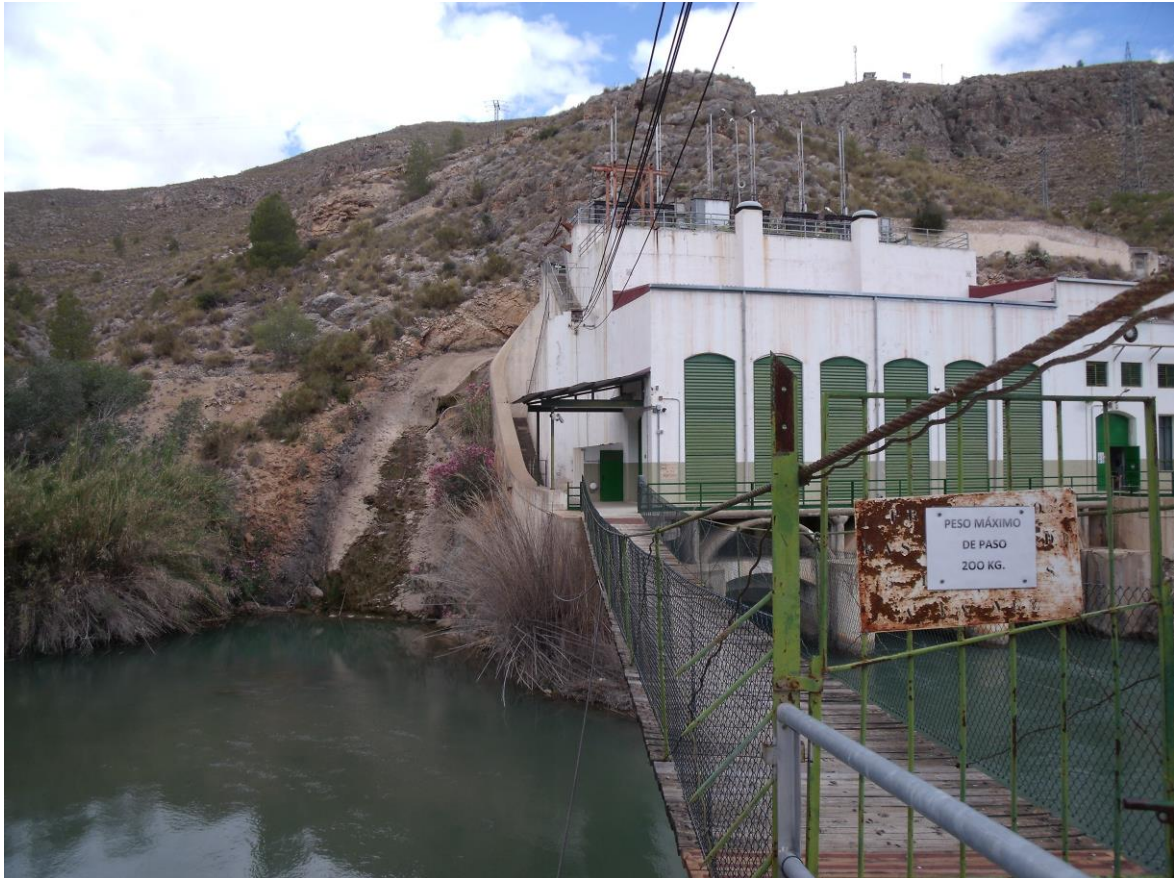
Figura 8. Central hidroeléctrica de Cañaverosa en la margen izquierda de Segura, en término de Calasparra. En junio de 2008, contaba con tres turbinas Frangis Doble Horizontal que le daba una potencia instalada de 3.918 KW.
