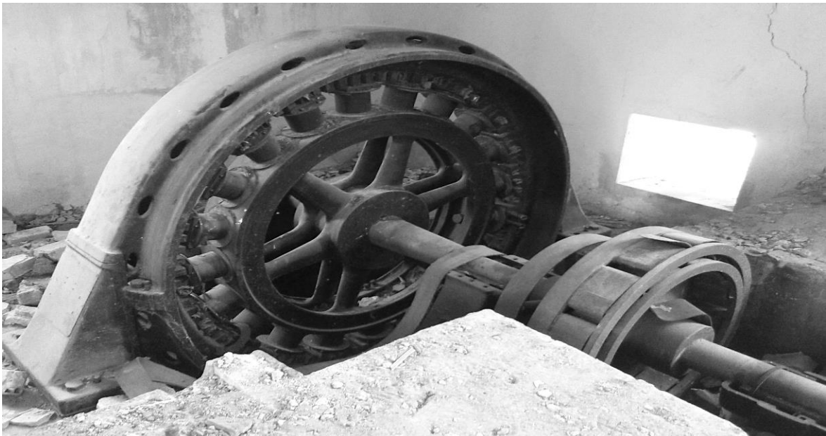
Figura 6. Restos de la central hidroeléctrica de "El Menjú", en la margen derecha de Segura en término de Cieza. En 1931 era propiedad de "Eléctrica del Segura S.A." con una potencia de 702 H.P. En el 2008, pertenecía a Iberdrola Renovables S.A.U., pero se abandonó.
