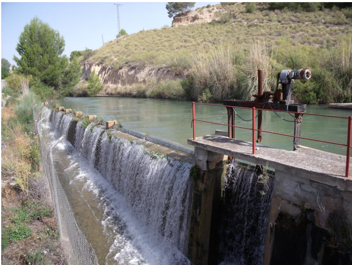
Figura 4. Río muerto a la central hidroeléctrica “Hoya de García” para “El Progreso S.A”, en la margen izquierda de Segura, en término de Cieza (Murcia). En 1931 tenía una potencia de 1.493 H.P. En el 2008 era propiedad de “Nuevos Riegos Progreso S.A.” con una potencia instalada de 2.535 KW.
