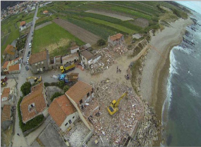
Figura 14: Recuo planeado do núcleo edificado e obras de requalificação em São Bartolomeu do Mar Fonte: POLIS LITORAL NORTE
